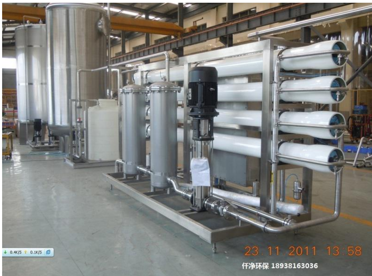
去离子水设备 RO 前置过滤器所用保安过滤展示
